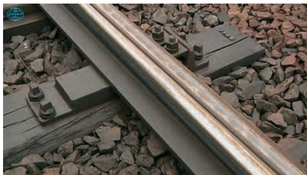
Bild 4: Schlupfwellen auf einer Backenschiene (Zunge bereits bearbeitet)
