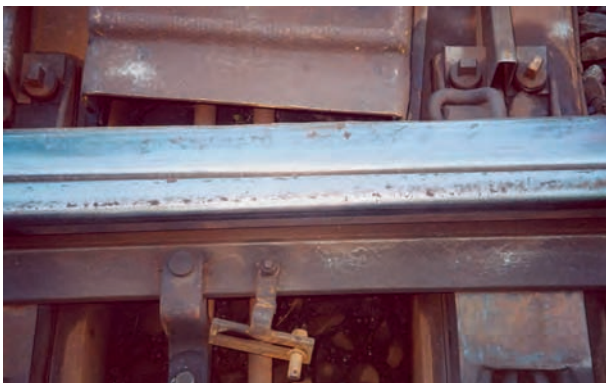
Bild 2: Rollkontaktermüdung in einer Weiche
